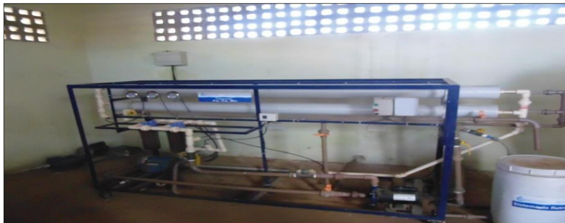
Foto 9 – Dessalinizador instalado na localidade Sobrado
