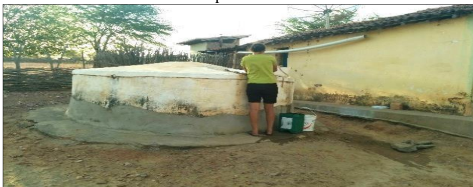
Foto 6 – Cisterna de placas na localidade Sobrado
